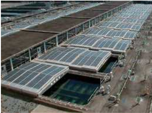
▲ろ過池の上の太陽電池
